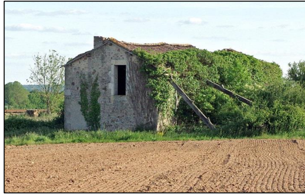
Bâtiment en ruine de la Naulerie Source : Les Snats 2020
