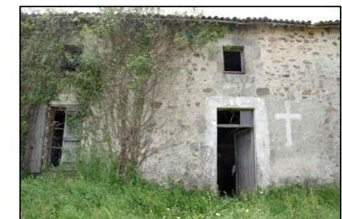
Bâtiment en ruine de la Naulerie, côté Nord Source : Les Snats 2020
