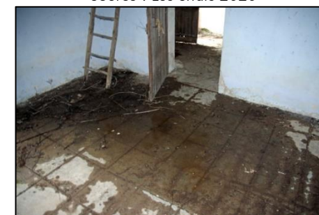
Rez-de-chaussée exposé aux intempéries Source : Les Snats 2020
