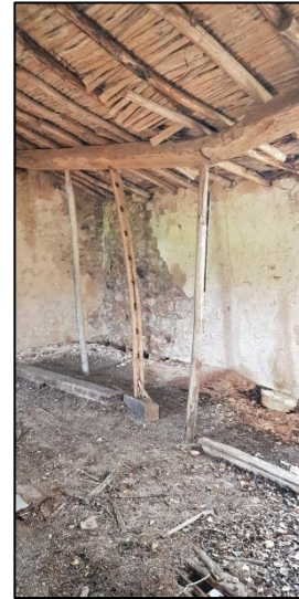
Charpente prête à tomber Source : Les Snats 2020
